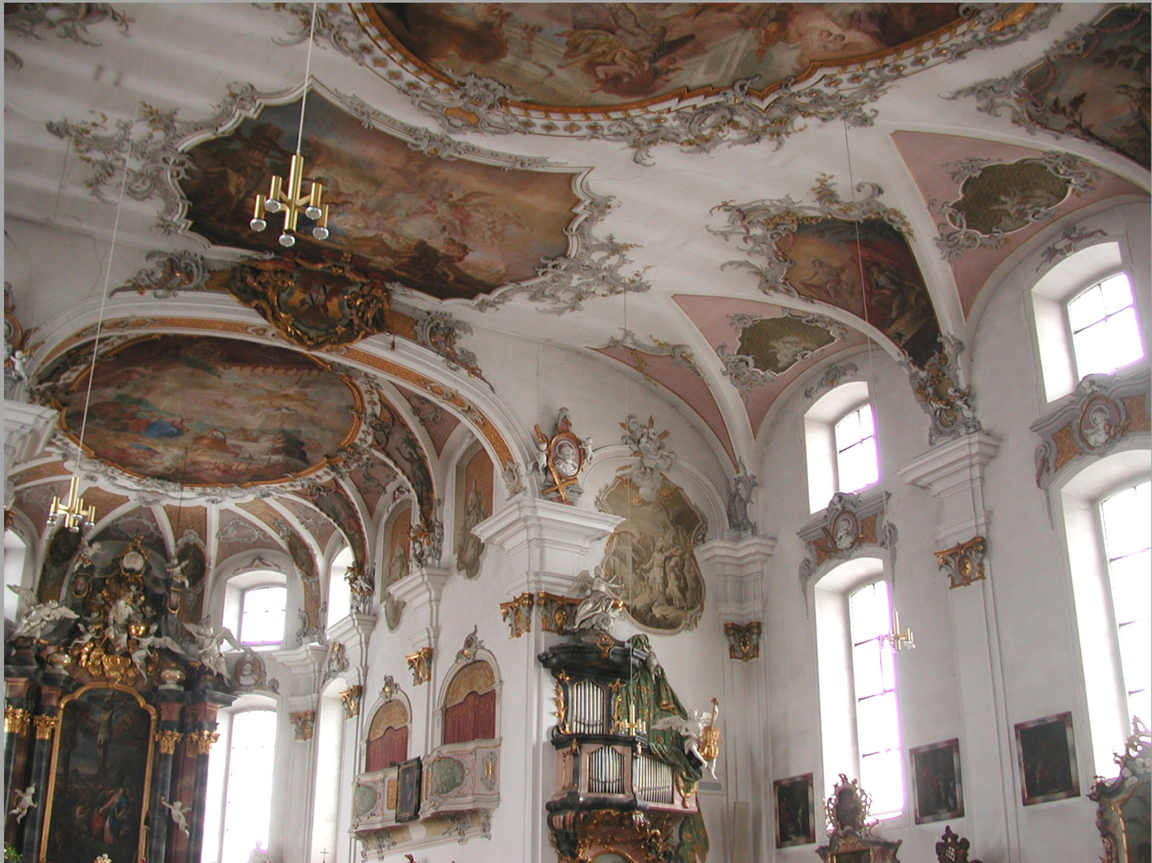
Meßkirch / Asamkirche (Schmutzablagerung an der Decke zwischen den Balkenlagen)
