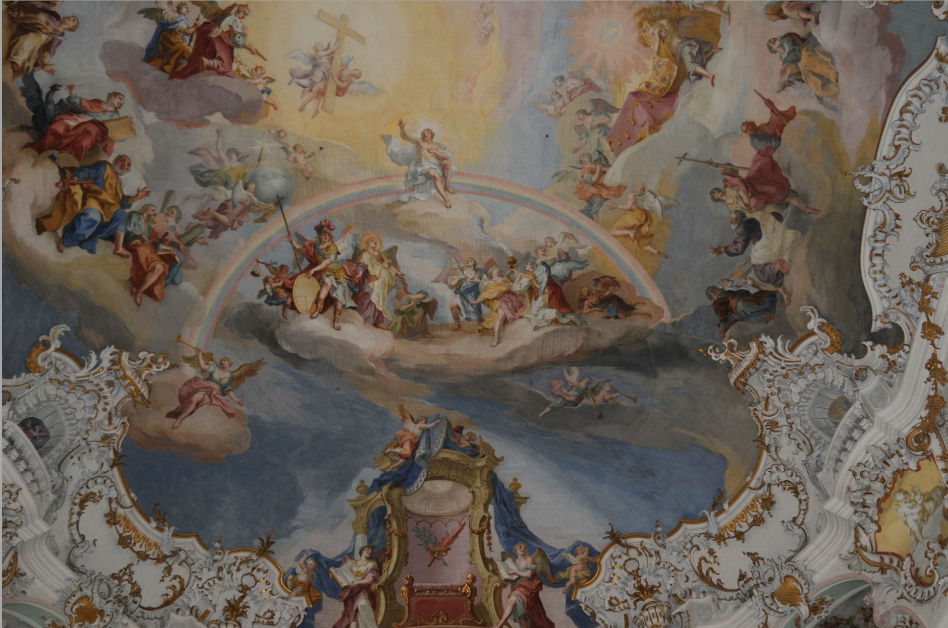
Wieskirche (Steingaden) / Deckengemälde von Johann Baptist Zimmermann, 1753–1754 / (Schmutzablagerungen zwischen der Lattung der Decke)
