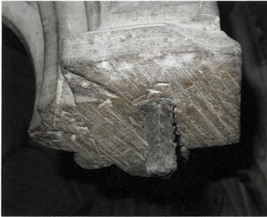
Abb. 204: Berner Münster, Priesterdreisitz (um 1440): Eisendübel mit »Widerhaken« in einem Baldachin. An diesem Dübel war früher wohl die ornamentierte Eckausbildung des Baldachins befestigt. Die Widerhaken sollten das Abrutschen dieses Zierteils verhindern. Foto: Berner Münster-Stiftung.
