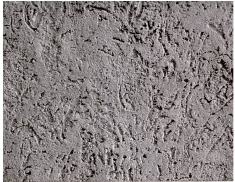
Unregelmäßig verriebener Putz
